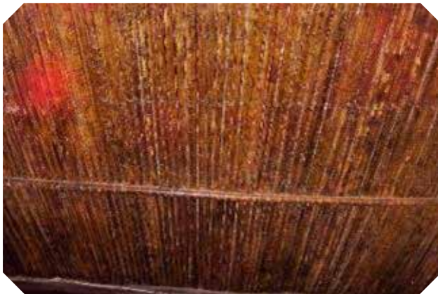
Techado de Caña Hueca
